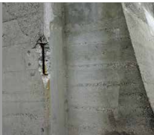
Durch Eisenkorrosion abgeplatzter Beton
