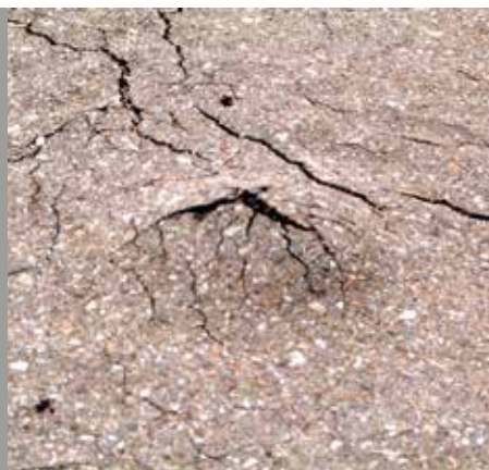
Terrassenboden: Risse und Beulen
