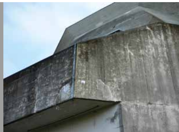
Fassade mit beschädigtem Beton
