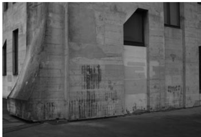
Bild: Betonschäden an der Nordfassade Goetheanum Rostfahnen und Abplatzungen
