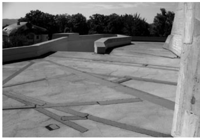
Bild: Terrassenbereich Süd mit provisorischen Reparaturen
