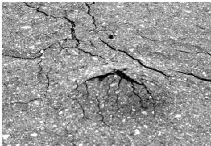
Bild: Blasenbildung im Gussasphalt auf der Südterrasse
